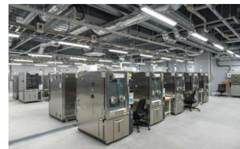
恒温槽・熱衝撃試験室
